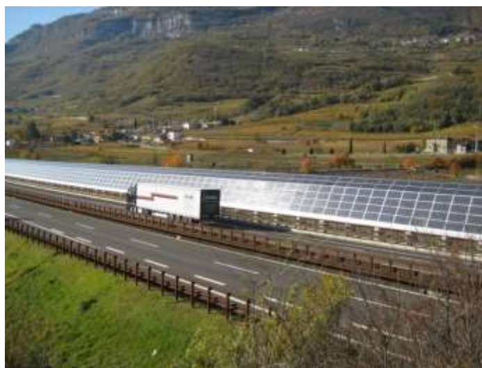
Figura 8: Installazione di barriere acustiche munite di moduli fotovoltaici lungo l'autostrada A22 "del Brennero" [19]
